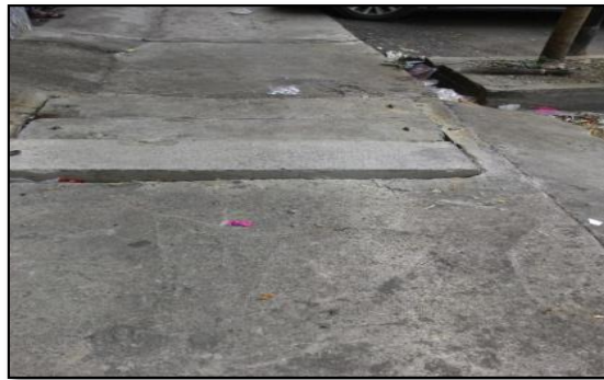
Gambar 3. Inlet yang tidak rata, mengganggu aksesibilitas pejalan kaki.
