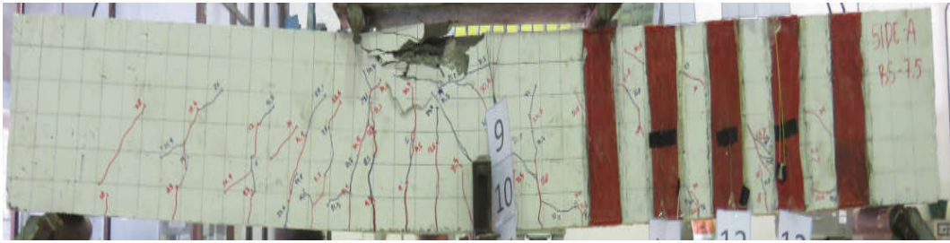
Gambar 8. Pola Retak Balok Beton Serat 7,5 cm
