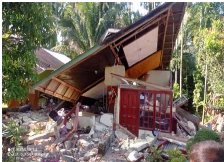
Gambar 8. Rumah roboh/rusak berat
