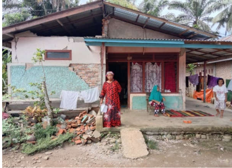
Gambar 4. Rumah rusak pada dinding
