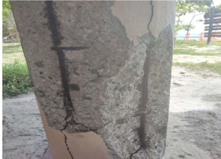
Gambar 12. Kolom praktis yang rusak
