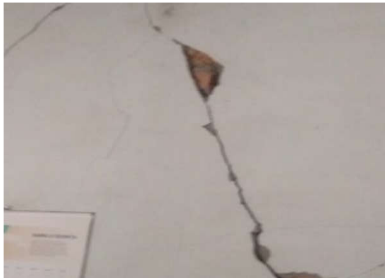
Gambar 9. Retak kecil pada dinding
