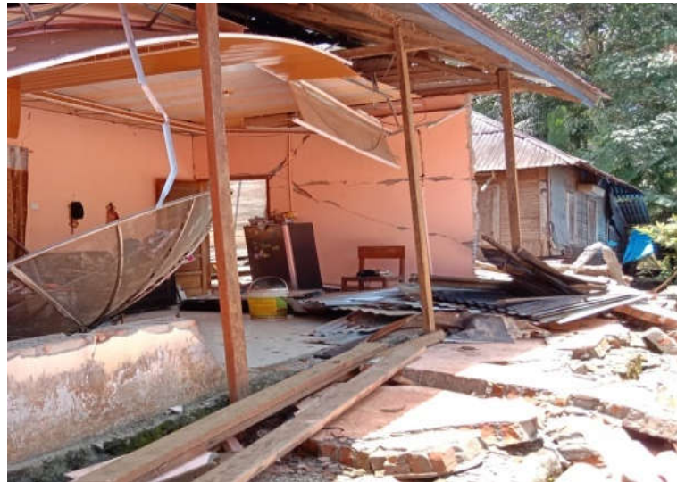
Gambar 7. Rusak pada plafond dan dinding
