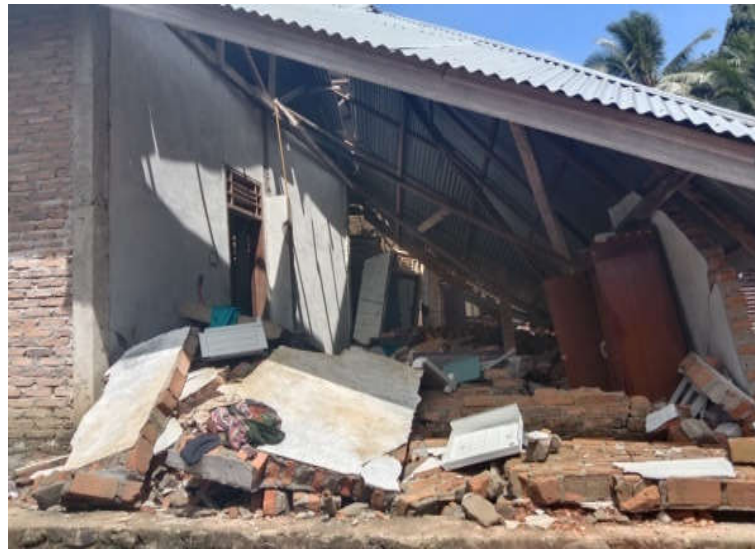
Gambar 6. Dinding rumah roboh
