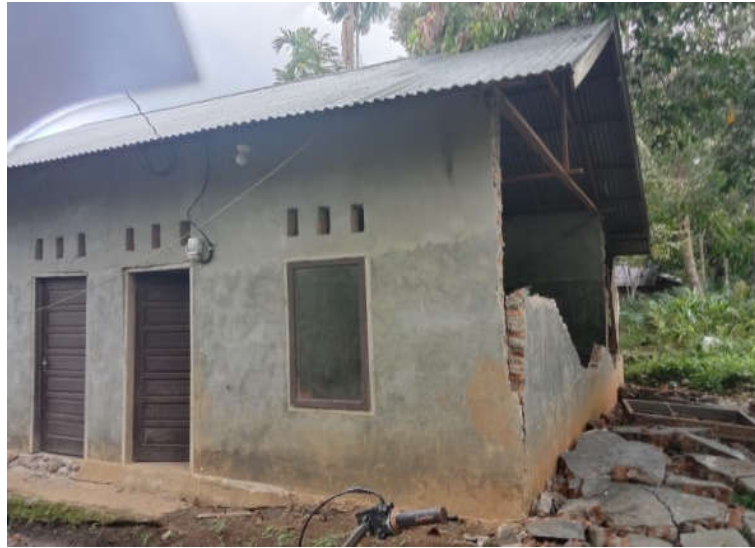
Gambar 10. Dinding yang hancur pada bangunan
