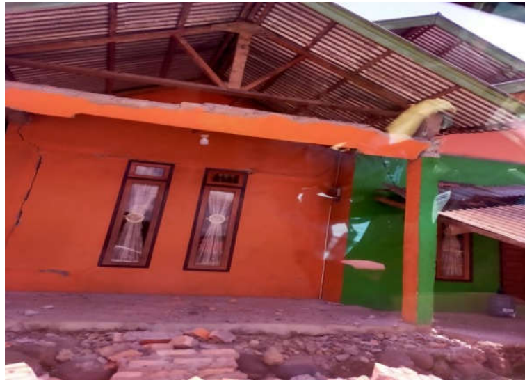
Gambar 2. Rumah rusak pada dinding
