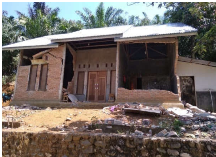
Gambar 5. Rumah rusak pada dinding
