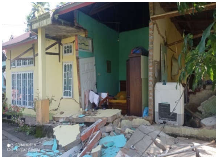
Gambar 3. Rumah rusak pada dinding kolom dan ring balok
