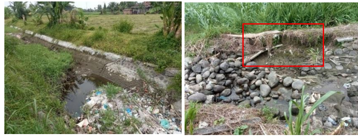
Gambar 3. Kondisi dinding saluran yang tersedimentasi dan mengalami kerusakan Sumber: Dokumentasi Pribadi
