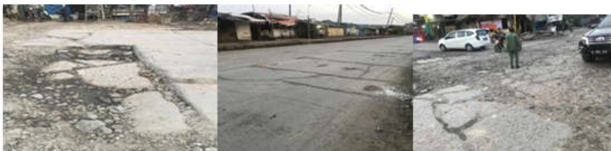
Gambar 2. Kondisi perkerasan di lokasi studi (Bessie, 2022)
