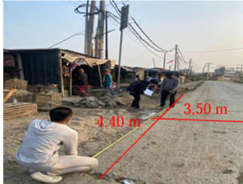
Gambar 2. Pengukuran Kerusakan pada segmen 1 arah Bandara (Bessie, 2022)
