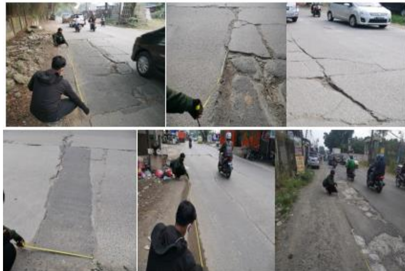
Gambar 3. Beberapa Kerusakan Pada Perkerasan Kaku Eksisting
