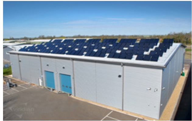
Gambar 1. Aplikasi BAPV pada atap suatu bangunan
