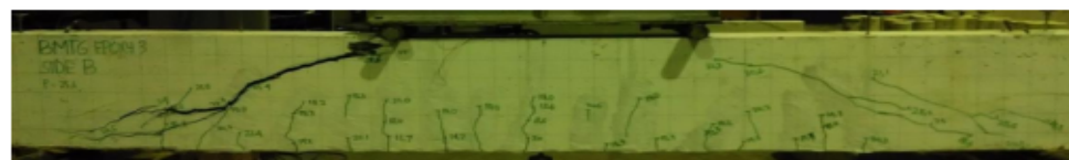
Foto Pola Retak BBMTG E-28 Setelah di Epoxy
