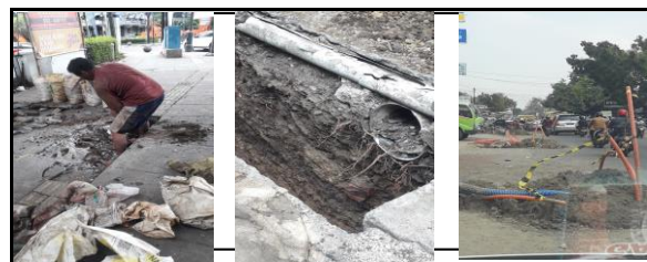
Gambar 1. Kerusakan Infrastruktur akibat pekerjaan infrastruktur lain
