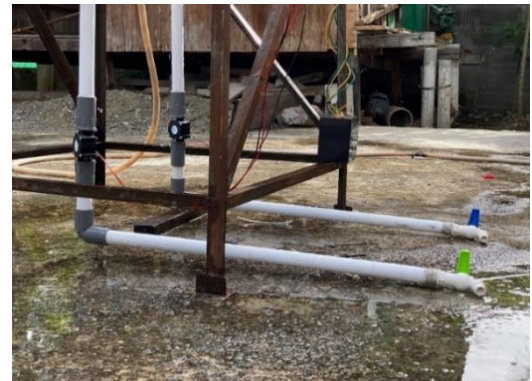
Gambar 10 Rangkaian pipa outlet dan generator pikohidro
