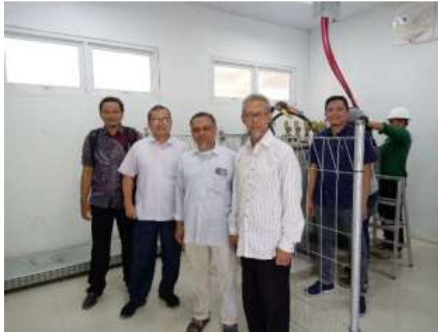
Gambar 7. Finalisasi proses commissioning antara tim teknis, produsen dan supplier dengan pemilik transformator
