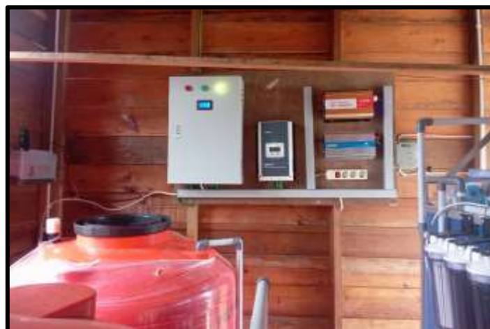
Gambar 7. Pengoperasian panel kontrol, uji komponen dan pemantau kinerja sistem
