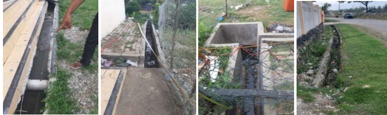
Gambar 6. Kondisi Eksisting Jaringan Drainase Sumber: Penulis, 2022
