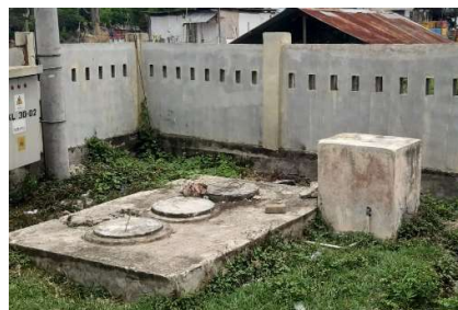
Gambar 8. Instalasi Pengolahan Air Limbah pada Rusunawa Lampulo Sumber : Dokumentasi Penulis, 2022
