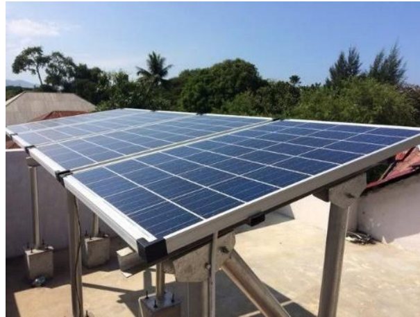
Gambar 7. Penerapan Panel Surya pada Gedung Perkantoran di Kota Banda Aceh Sumber: BAPPEDA Kota Banda Aceh (2022)
