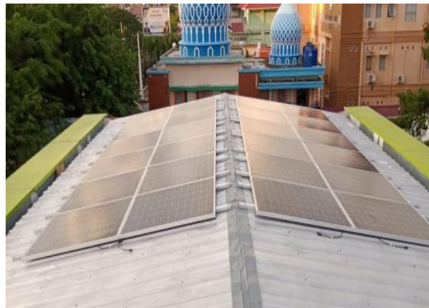
Gambar 2. Penerapan Lampu Solar Panel di Atap Gedung Pemerintah Sumber: BAPPEDA Kota Banda Aceh (2022)
