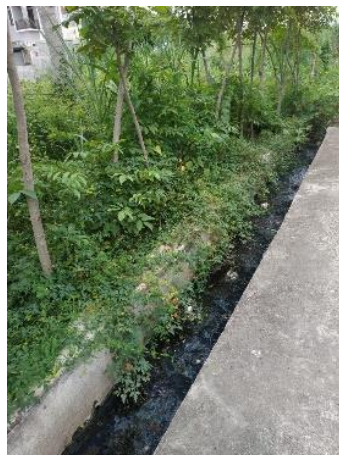
Gambar 25 Kondisi Drainase Eksisting Sumber: Ilustrasi Pribadi (2021)
