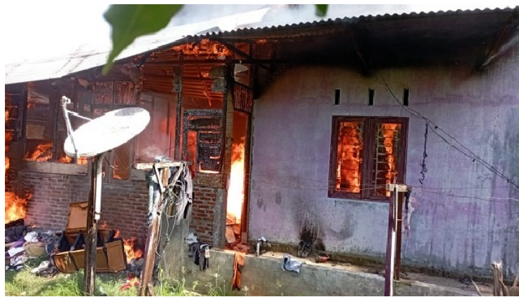
Gambar 3. Kondisi Rumah di Geulumpang Teungoh yang terbakar Sumber: https://habadaily.com/2023/02/21/satu-rumah-di-geulumpang-teungoh-terbakar-saat-ditinggal-pemilik/
